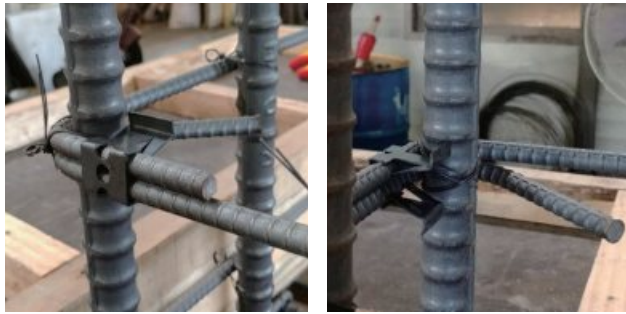
<그림 6> 체결 클립이 설치된 사례
