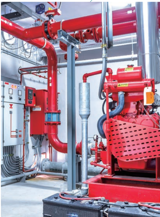
스프링클러 설치 시 건물 내에 소화펌프실을 만들어야 한다.
